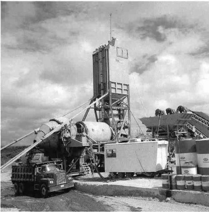
Planta para la producción de concreto.
